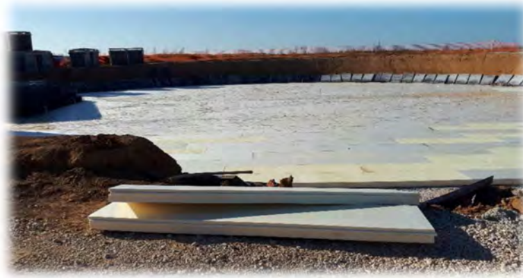
Figure 17 : Plaques de Styrodur® placées sous le radier d'une cuve de digestion (voie liquide) (source : Biogaz ingénierie)
