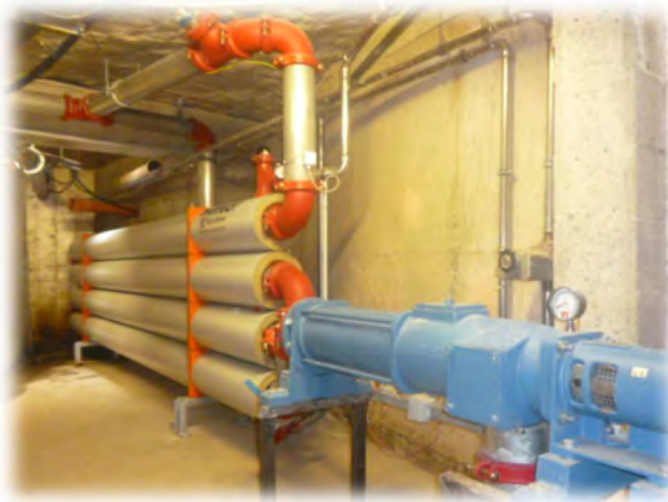
Figure 21 : Réchauffeur externe (source : Biogaz ingénierie)
