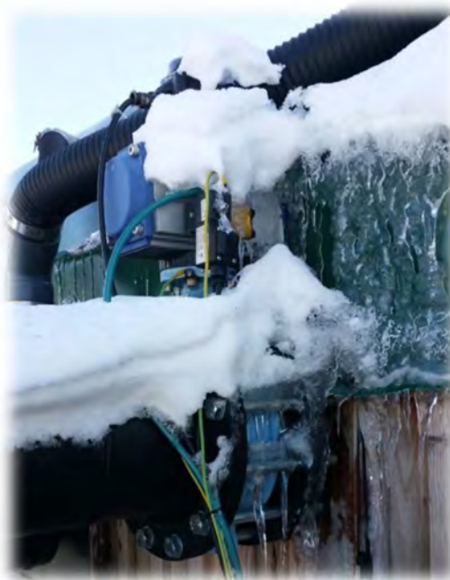
Figure 27: Photographie d'une vanne prise dans le gel (source : Biogaz ingénierie)
