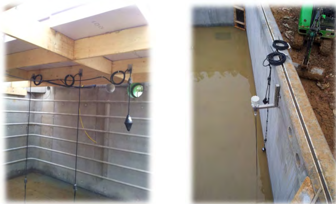
Figure 22 : Photographies de capteurs TOR type "poires de niveau" (source : Biogaz ingénierie)
