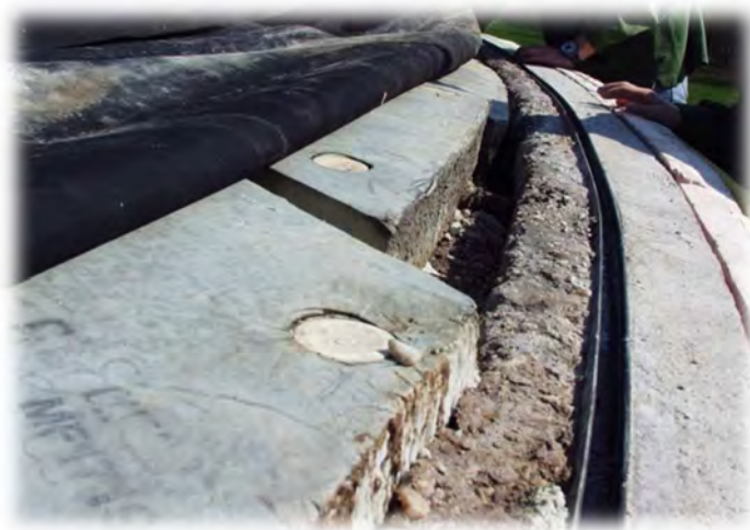
Figure 16 : Illustration de l'agression du béton due au soufre sur un digesteur (source : Biogaz ingénierie)
