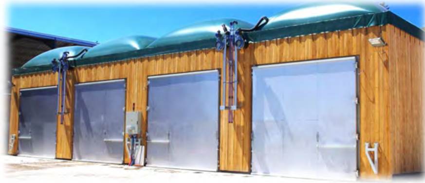
Figure 4 : Installation en voie sèche discontinue, concept garages (Source : Installation Naskéo Méthajade en Côte d'Or)
