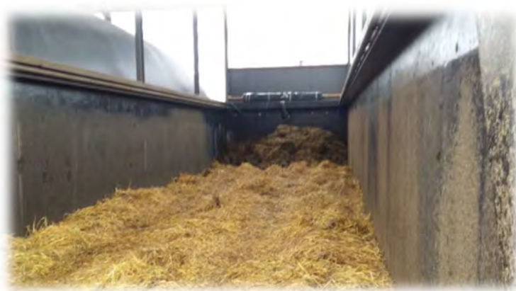
Figure 2 : Photographie d'un digesteur de type silo bâché ouvert (source photo : biogaz ingénierie)
