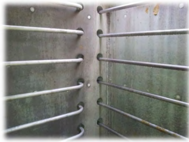
Figure 20 : Système de chauffage serpentin INOX (source : Biogaz ingénierie)
